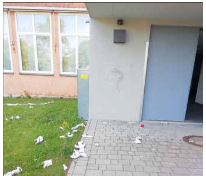
Rasierschaum beschädigt Farbe und Putz am Anbau der Küche an der Turnhalle. Das Klopapier ist leider eine weitere Unsitte in der Walpurgisnacht.
