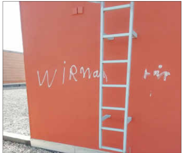
Die Nordfassade der Turnhalle wurde auf dem Vordach (!) durch Rasierschaum in der Walpurgisnacht erheblich beschädigt. Ein kompletter Neuanstrich erscheint notwendig. Der Schriftzug liest sich „Wir waren hier“.
